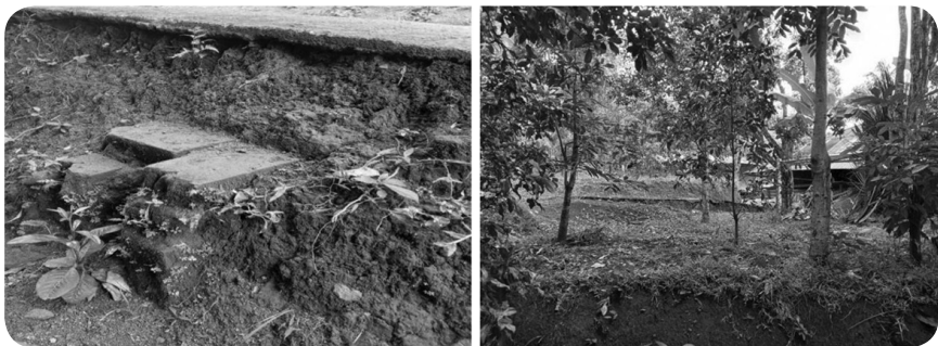
Gambar 9. Kondisi Bangunan di Titik 4 yang Sudah Rata dengan Tanah Sumber: Widnyana, 2021
